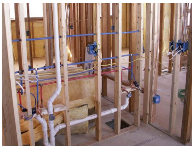
Figura 3: Sistema elétrico e hidráulico instalados.
