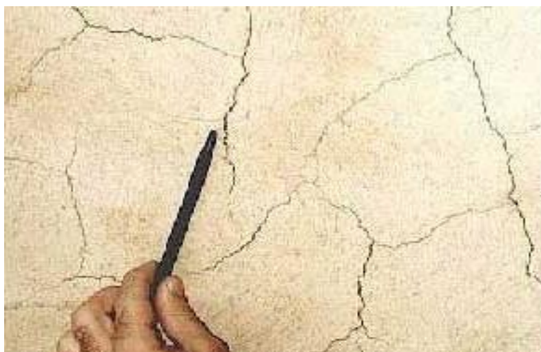
Figura 7 - Trincas e fissuras em laje de concreto
