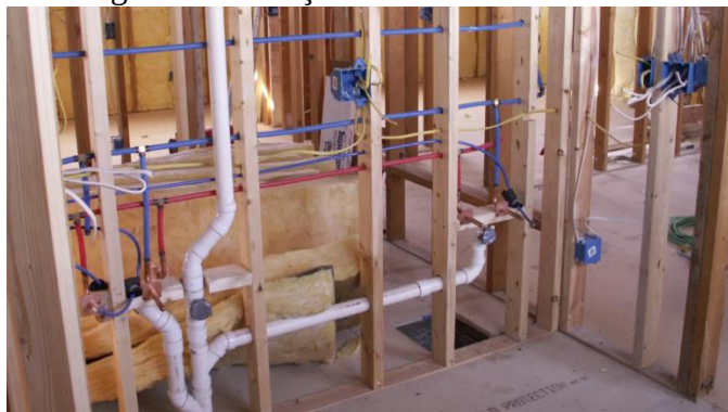
Figura 9 Instalação Elétrica na Madeira
