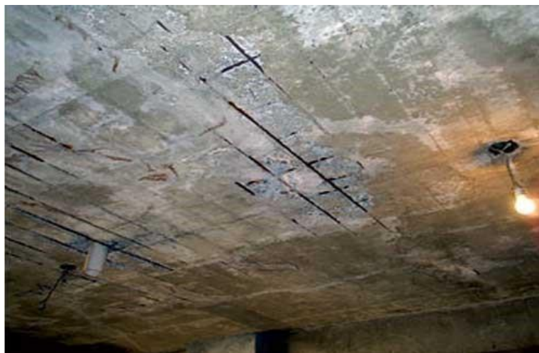
Figura 4 – Laje com armadura exposta
