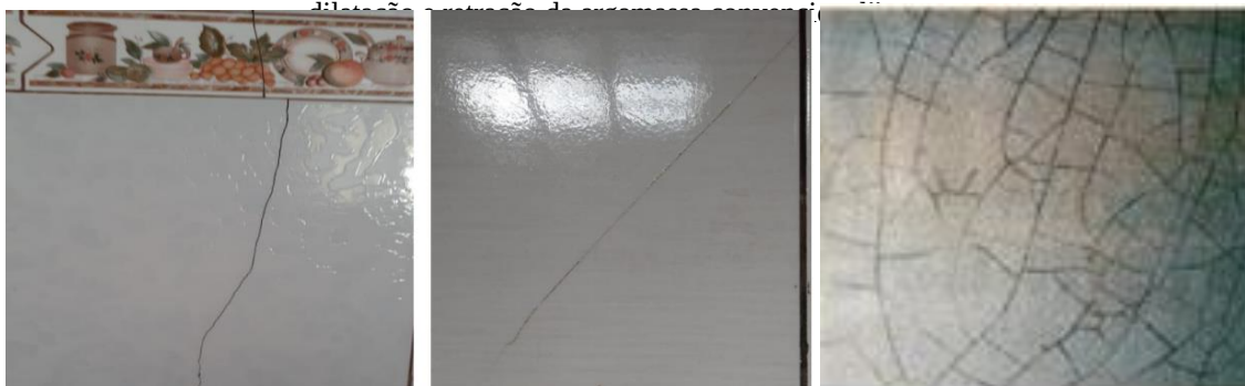
Figuras 2: Trinca, Fissura e Gretamento no Revestimento Cerâmico. Fonte: Silva, 2021.
