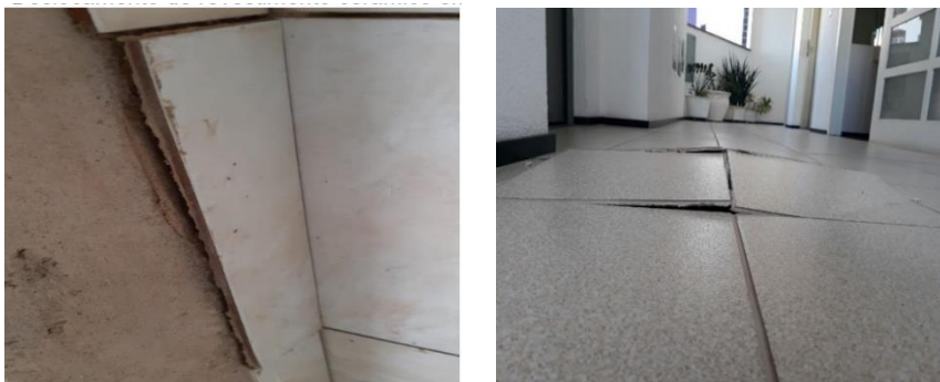
Figuras 1: Destacamento ou Descolamento do Revestimento Cerâmico. Fonte: Silva, 2021.
