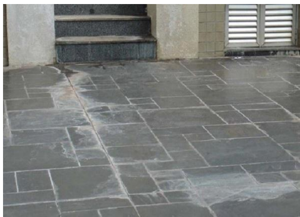
Figura A-9: Efeito do fenômeno da Eflorescência
