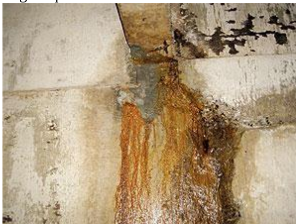
Figura A-1: Corrosão de armaduras
