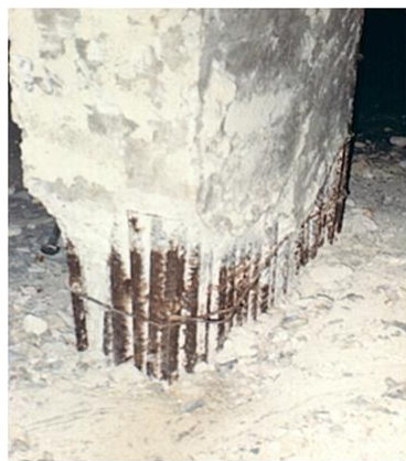
Figura A-4: Corrosão das armaduras na base do pilar
