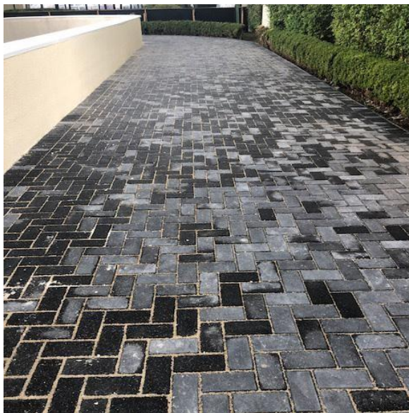
Figura A-8: Efeito do fenômeno da Eflorescência
